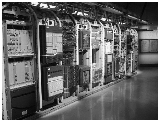
Quelques baies d'équipement réseaux
